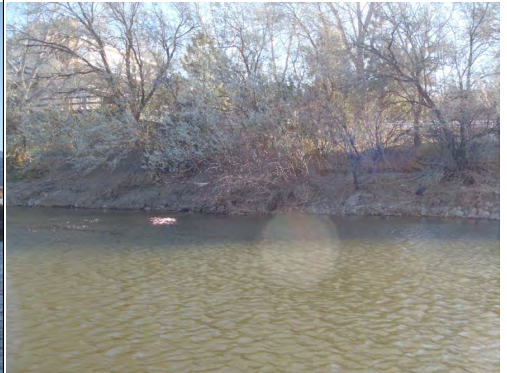
Rock Toe-Pipe Map-1-005
